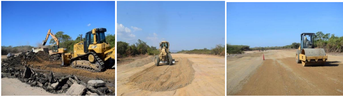
Demolición y Excavación infraestructura existente Instalación de Estructura granular Instalación de Estructura granular
