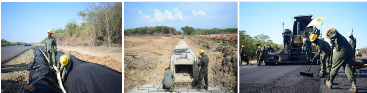
Construcción de filtros francés Construcción de Box Coulvert 93 cms longitud Instalación Asfalto FAAP-401
